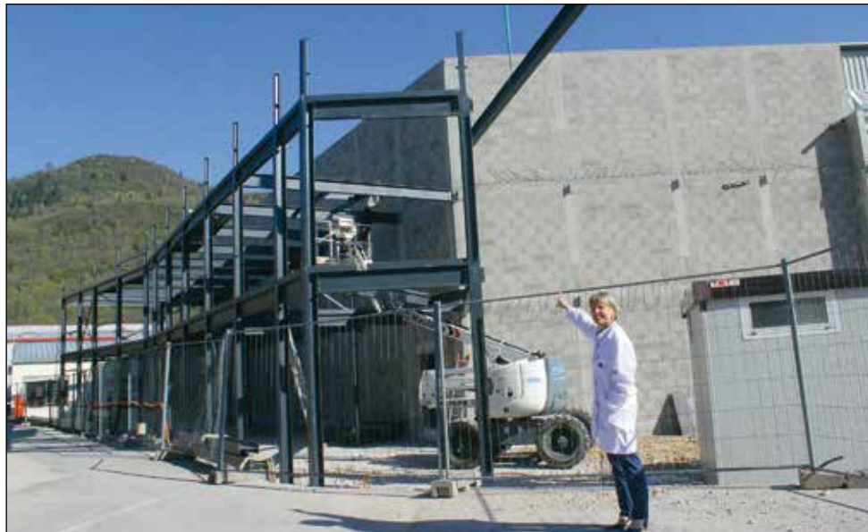
Sur le site de Molinges, l'extension de l'entreprise avance très vite, comme nous le montre Mme Maryse Eyssautier, P.D.-G., portera sur 1200 m 2 ce qui va libérer 800 m 2 en production. Un investissement pour ce projet de plus de 2 millions d'euros.
